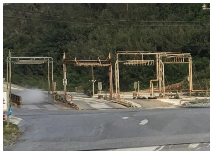
車両用粉塵防止の散水設備
