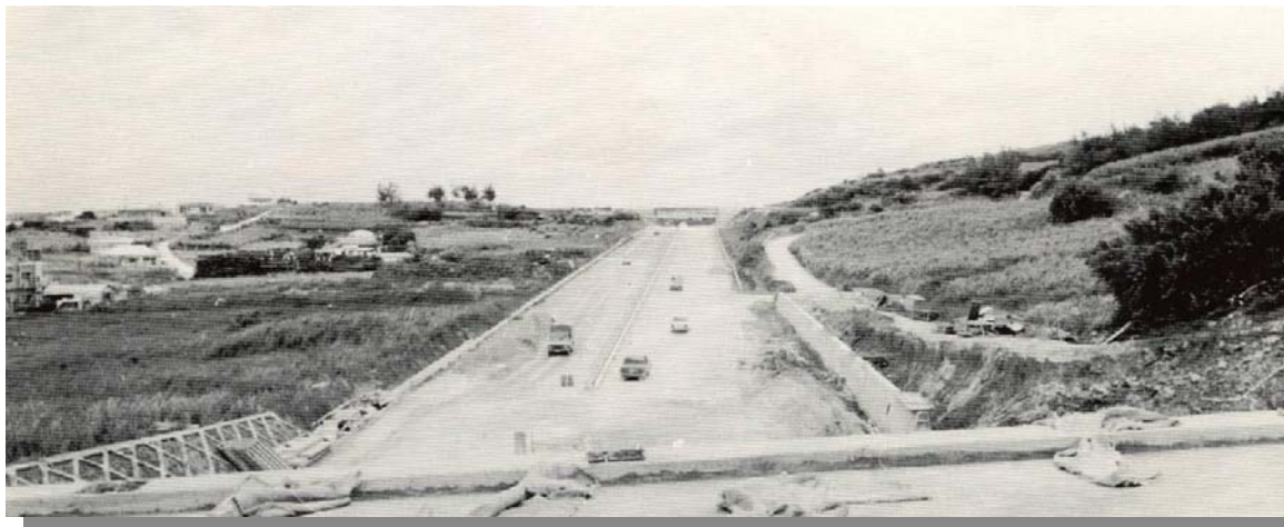
浦添市をほぼ南北に縦断する国道330号線の施工中（昭和47年）
